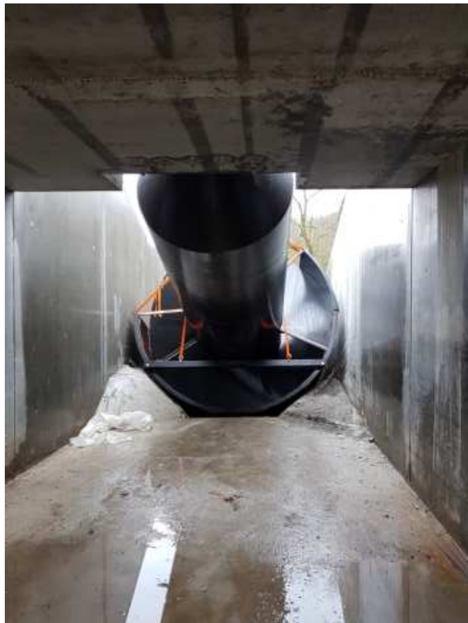
Figure 20 : Vue de la vis à partir du canal d'amenée - Méry, Belgique
